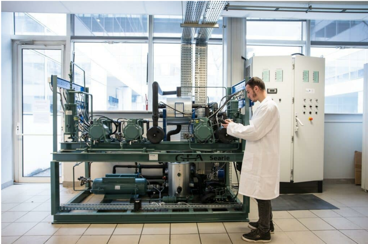
Une centrale frigorifique CO2 du lycée Raspail utilisée par un stagiaire du GPI2D.
